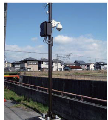
12 水位監視カメラ
