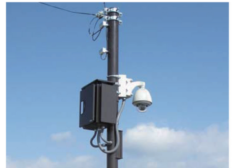
21 路面冠水監視カメラ
